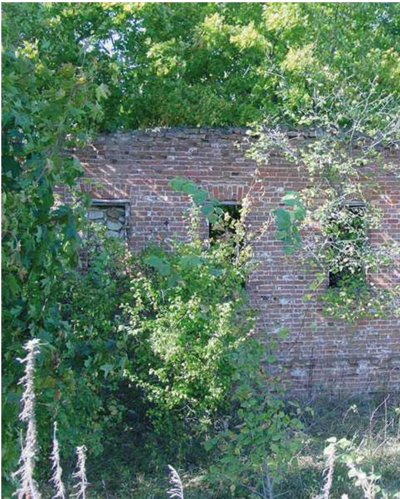
Разрушенное здание мечети первой пол. XIX в. на окраине Т. Пенделки
